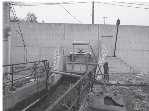
津波後のオートゲート
