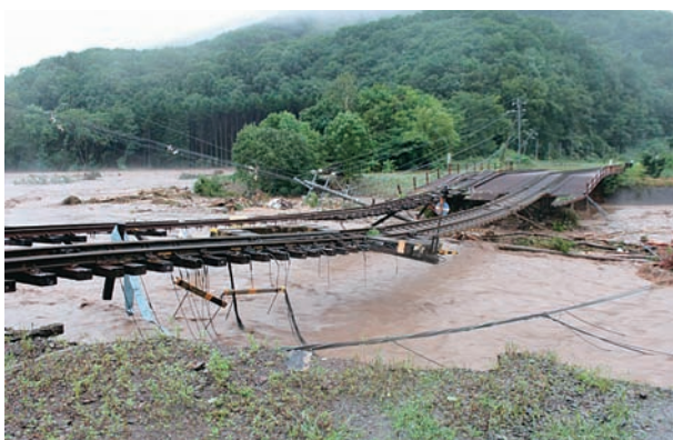
災害直後のパンケシントク川に架かるJR鉄橋
