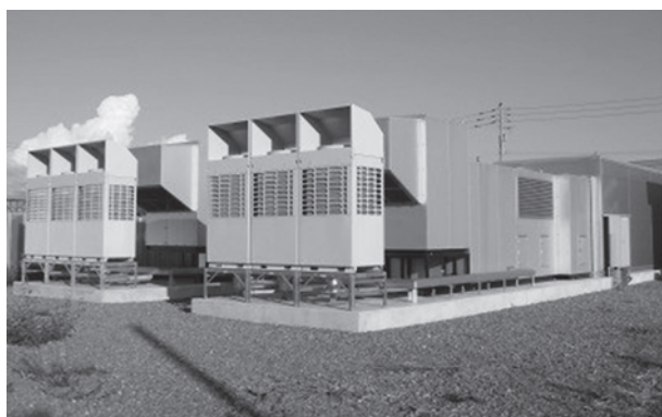
環境配慮型クラウドデータセンター
