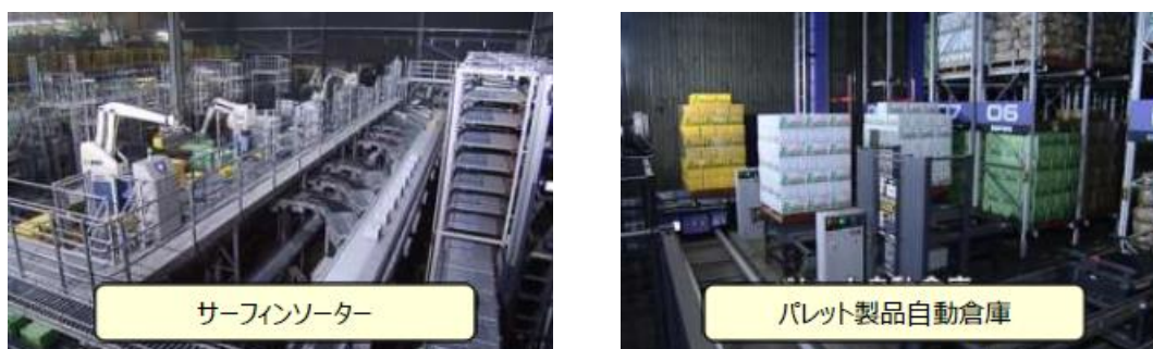
図 43 サーフィンソーターとパレット製品自動倉庫
